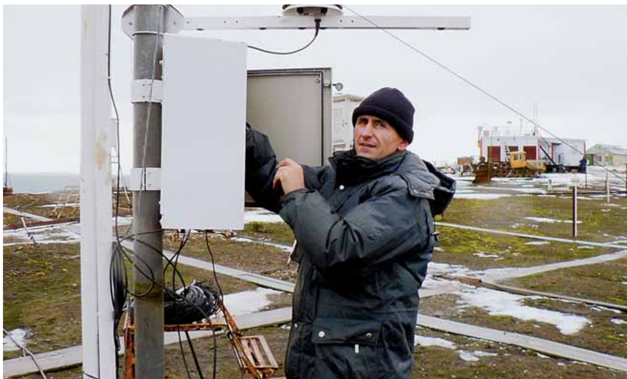
Монтаж современного оборудования на станции им. Э.Т. Кренкеля во время летней навигации специалистом Северного УГМС В. В. Шевченко
